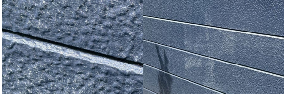
サイディングの溝や粗面の白残り
