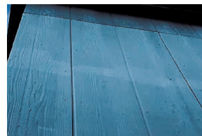
「足場つなぎ」箇所の艶ムラ
