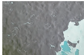
造膜途中の降雨による剥離
