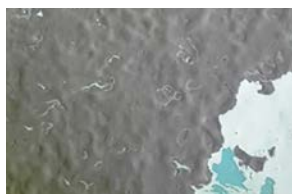
造膜途中の降雨による剥離
