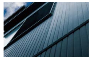
縦張りサイディングの塗装ムラ
