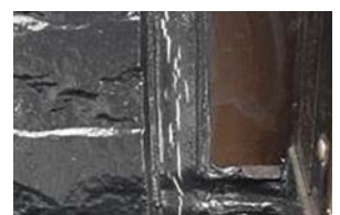
シーリング材の痩せによる割れ
