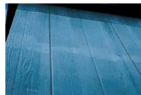
「足場つなぎ」箇所の艶ムラ
