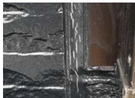
シーリング材の痩せ による塗膜の割れ
