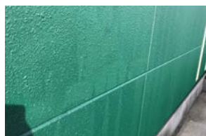
低温・高湿による施工ムラ
