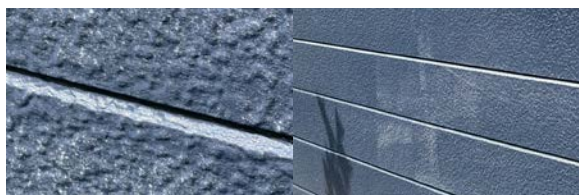
サイディングの溝や粗面の白残り
