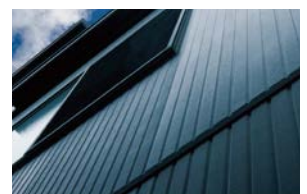
縦張りサイディングの塗装ムラ
