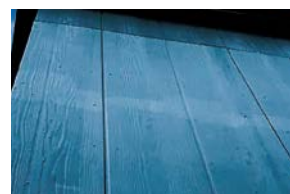
「足場つなぎ」箇所の艶ムラ
